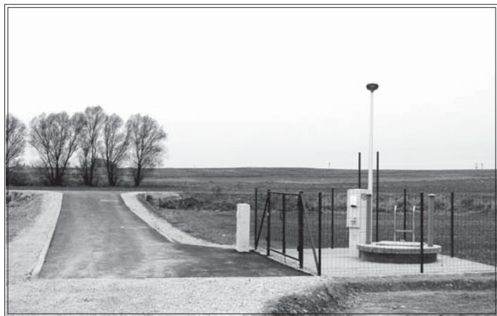
Przepompownia wody przy ul. Więźniów Oświęcimia
